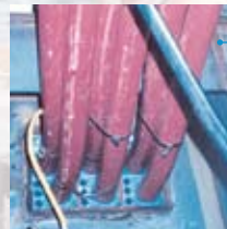
防火区及电缆存储区之间的穿隔。
