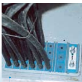
变压器平台防火区之间的穿隔。
