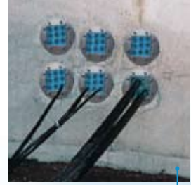
地基内电缆入口室的穿隔。
