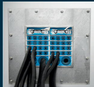
制御・計装ケーブル
