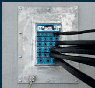
MV / LV 電力ケーブル
