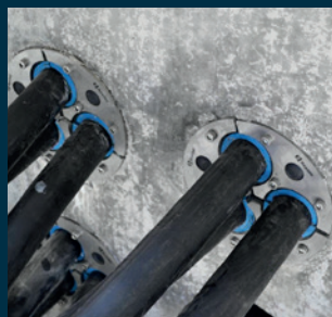
Cables de alimentación de AT
