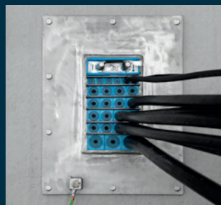
Cables de alimentación MT y BT
