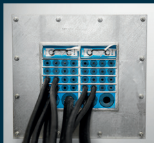
Cables de instrumentación y control
