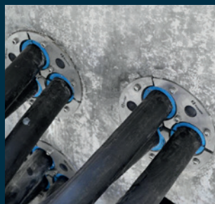
Câbles d'alimentation HT
