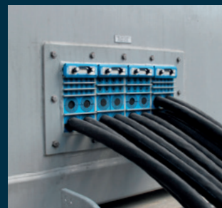
Salas de controle
