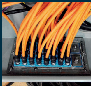
Gabinetes de rastreamento de aquecimento elétrico
