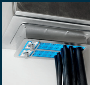
Armários de I/O remotos
