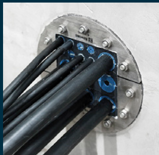
Cruce de cable en pórtico ferroviario
