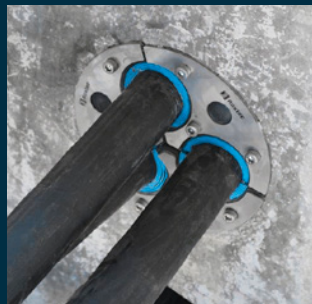
Foso para cables
