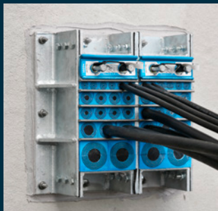
Salas de transformadores
