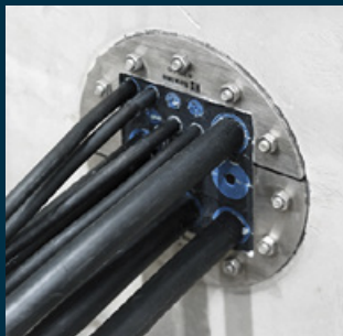
ガントリークレーン 配線設備
