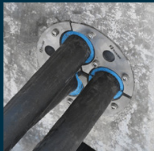
ケーブルピット
