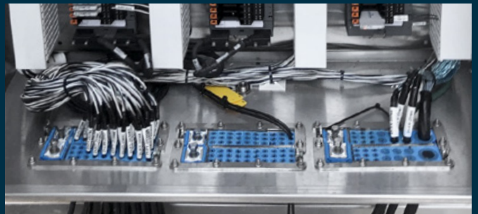
監視・IoT 機器収納キャビネット
