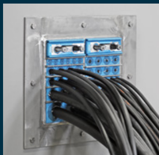
低電圧設備室
