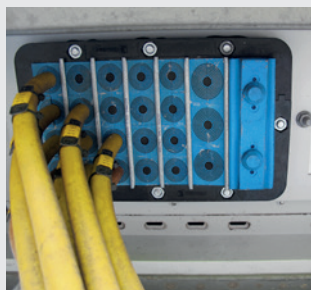
Painéis de controle
