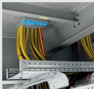
Instalações de controle
