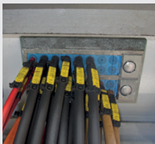
Caixas de junção instaladas em campo
