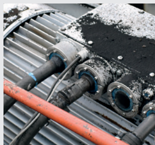
Motores instalados em campo
