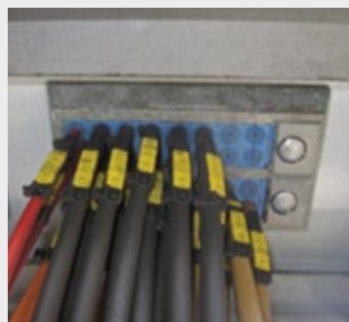
Соединительные коробки на объектах
