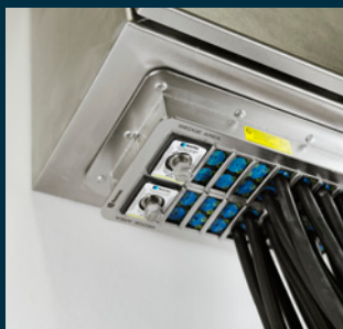
Armario de control
