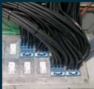
7. Armoires de conversion d'énergie
