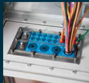
4. Armoires de sous-stations
